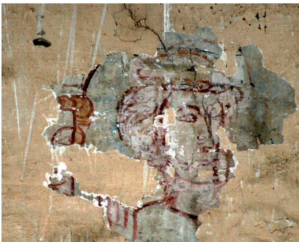
Iglesia de San Salvador. Restos de pintura mural en el muro del primer tramo de la nave por el lado sur.
